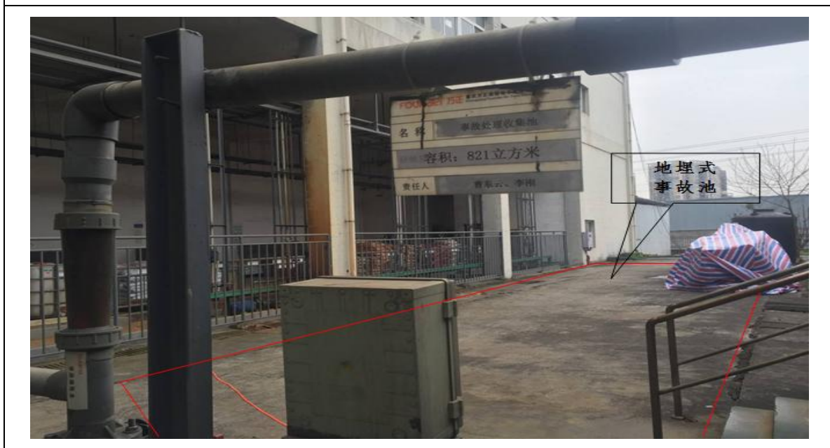
可视化环形地沟、收集井，收集井连接厂区事故池。
