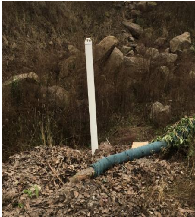
生化池臭气排放管
