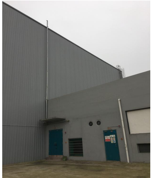
备用柴油发电机组产生的尾气经专用烟道排放 至屋顶高空排放
