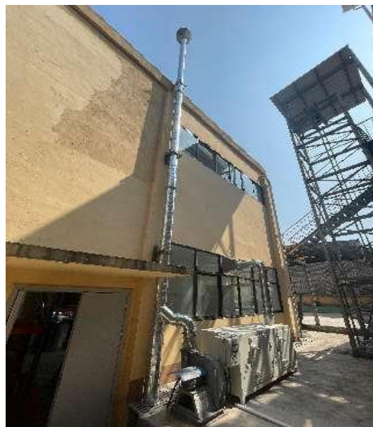
危废暂存间废气处理设施及废气排放口（DA003）
