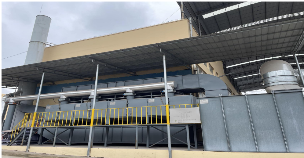
现有项目废气处理装置（干式过滤除漆雾（漆雾捕集+过滤箱）+活性炭吸附浓缩+催化氧化）
