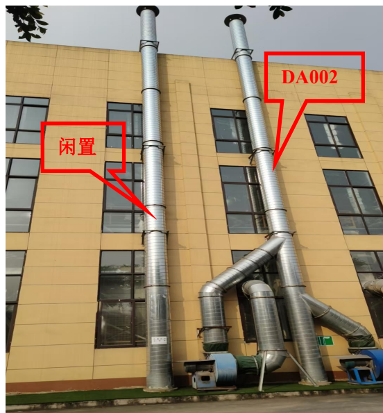
验收项目废气排放口（DA002）
