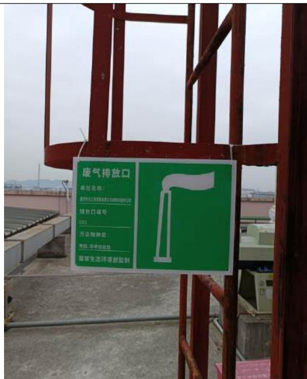
工艺废气排放口设置情况 DA001
