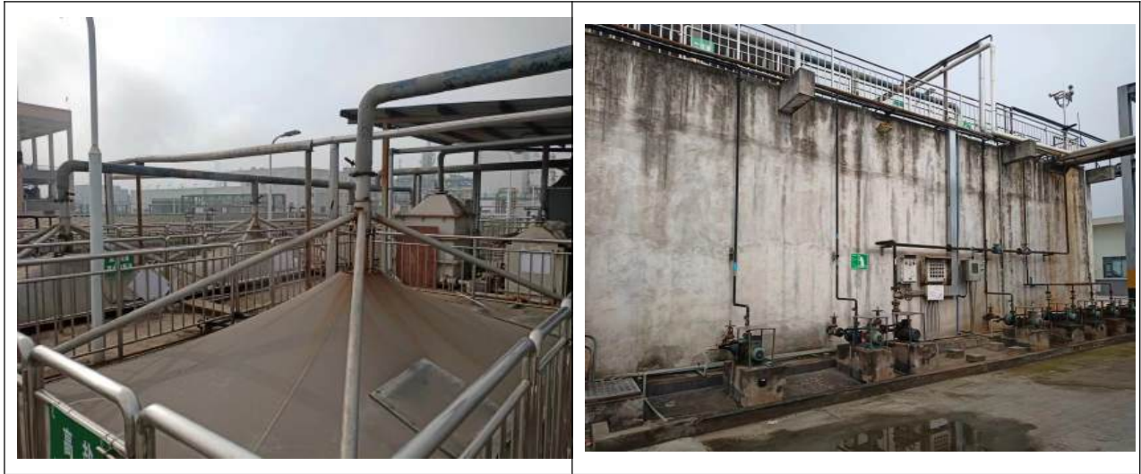
图 4.1-5 废水处理站设置情况图
