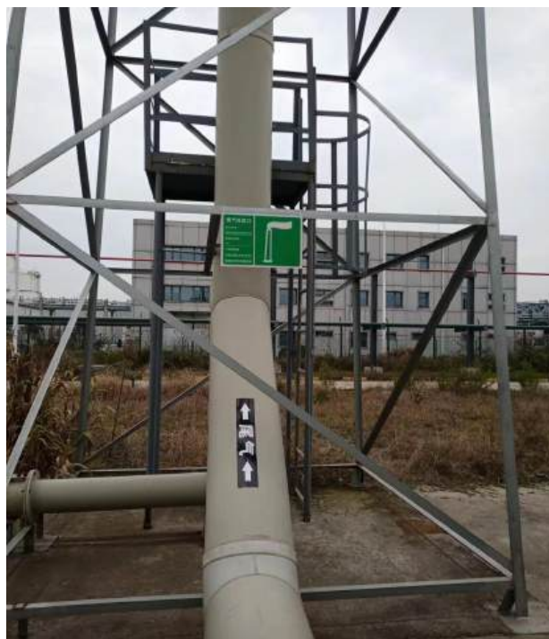
污水处理站及危废暂存间废气排放口设置情况 DA002
