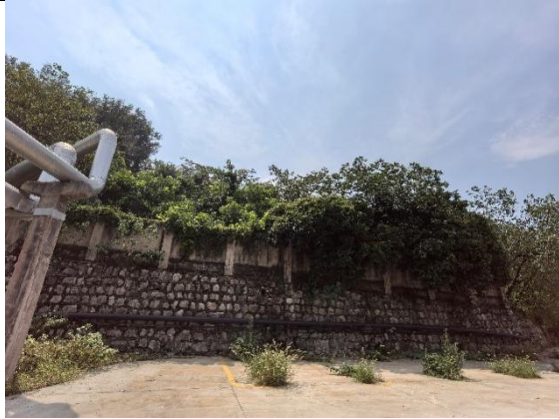
变电站西南侧
